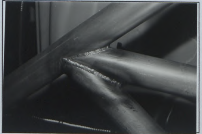
PHOTO N° 09 noeud arriere longitudinal gauche
