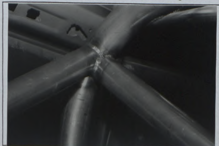
PHOTO N° 04 arceau central supérieur gauche
